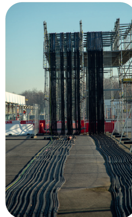
500 km de câbles déployés
